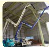
圧送ステーション
