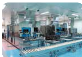
学校給食センター厨房
